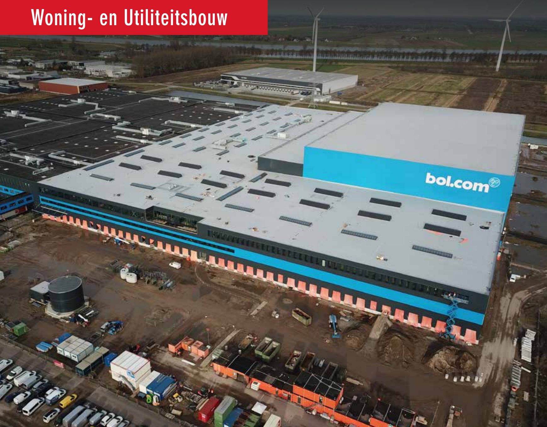
In slechts zeven maanden tijd is een staalconstructie van in totaal 5,6 miljoen kilo staal gebouwd.
