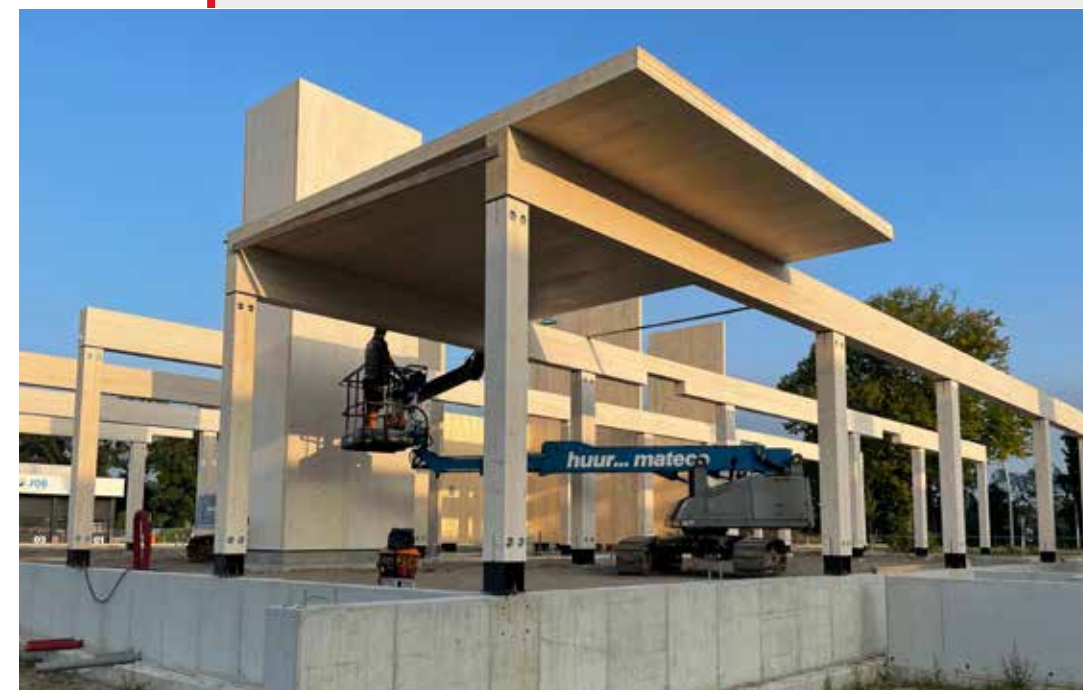
Vanaf de betonconstructie is gekozen voor een houten skelet met voornamelijk CLT kolommen, liggers en vloeren. En ook de dakvloer is volledig van hout.
